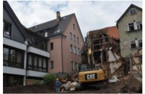
Weil die Volksbank (links) Platz benötigt, werden für einen Neubau die beiden Häuser und die Scheune abgerissen. Foto: Lenz
